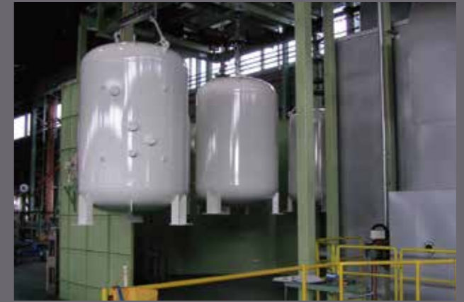
▲粉体塗装設備
